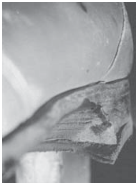
Рис. 448. Вигляд ушкодження, що на рис. 447, спереду.
